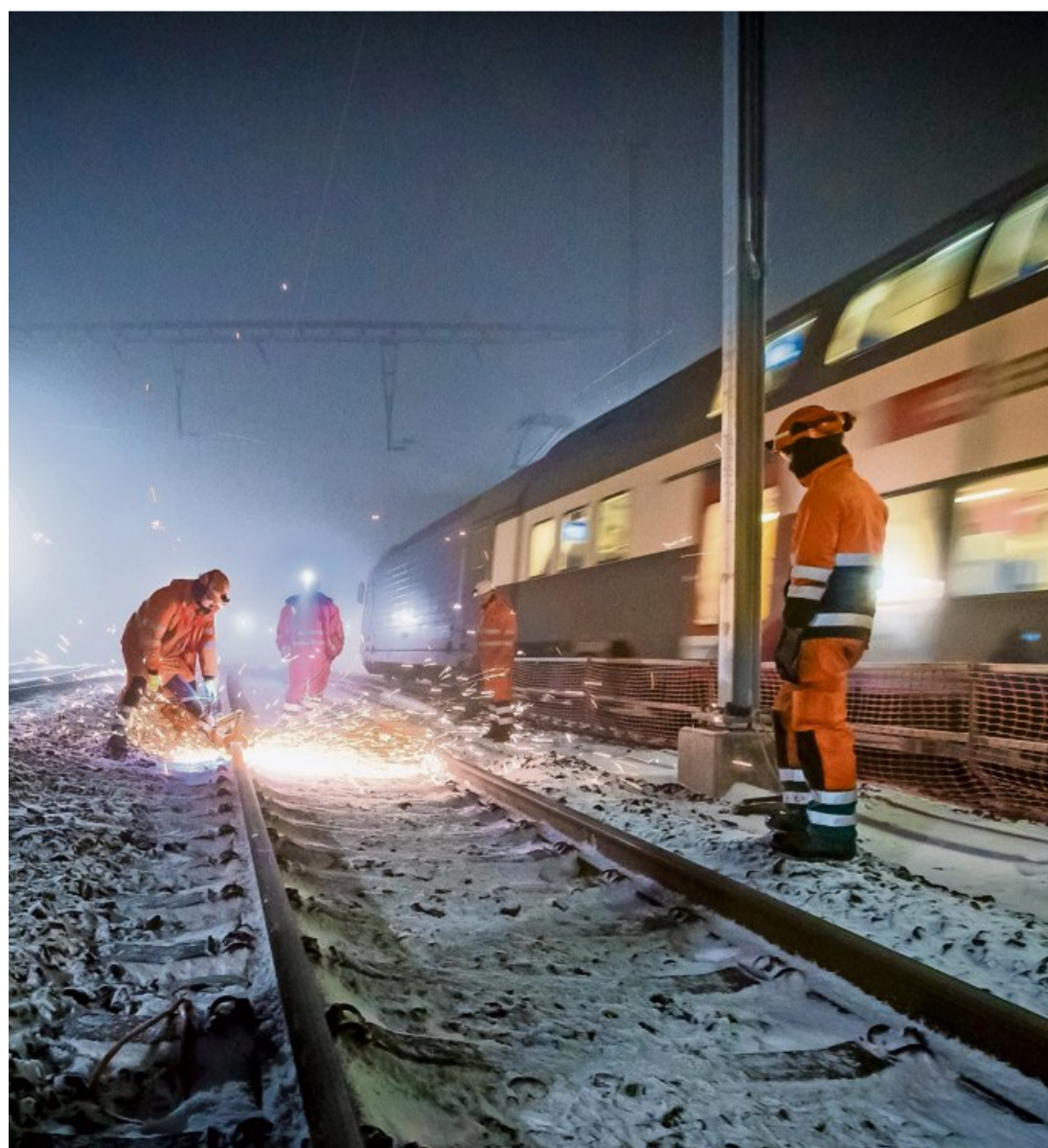
Vor dem Abtransport mussten die alten Gleise mit einer Trennscheibe zerschnitten werden.
